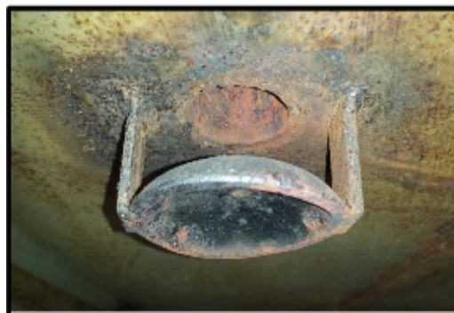
Figura 4.1. Difusor en entrada de vapor a la cámara.
