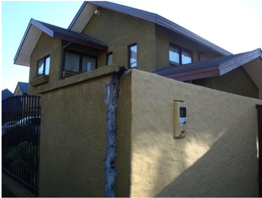
Figura H9. Barrio Lomas de San Andrés, Calle 8. Se observa daño y desplazamiento en muro externo.
