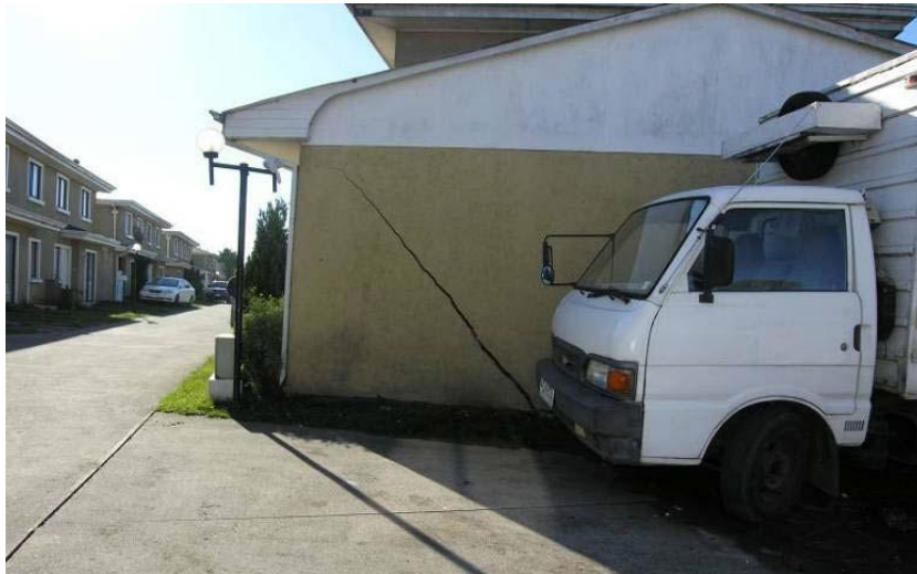
Figura H25. Condominio Andalién. Se observa grieta en muro en de vivienda.
