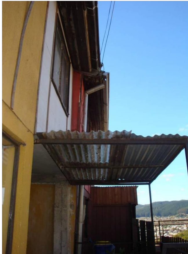
FiguraH5. Casas del pasaje Tirso de Molina. Se observa asentamiento de las viviendas y desacople de las casas en el segundo piso (flecha roja).
