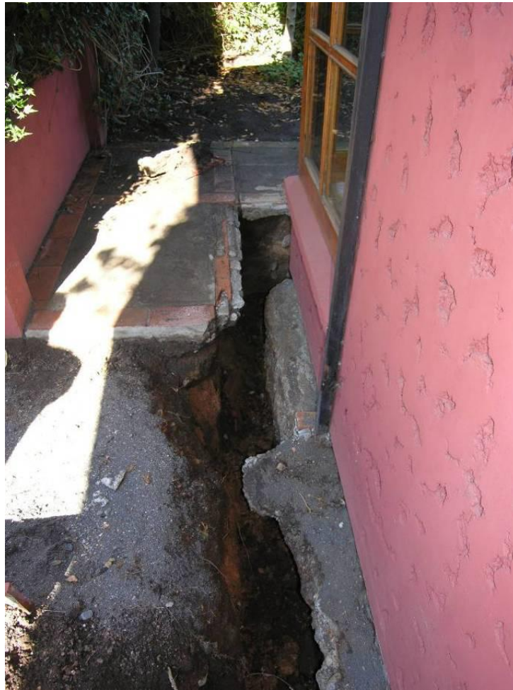
Figura H14. Barrio Lomas de San Andrés, Barrio Los Españoles, casa 6. Se observa hundimiento de la vivienda en más de 35 cm. La flecha muestra arenas arrastradas por los “golpes de agua”.
