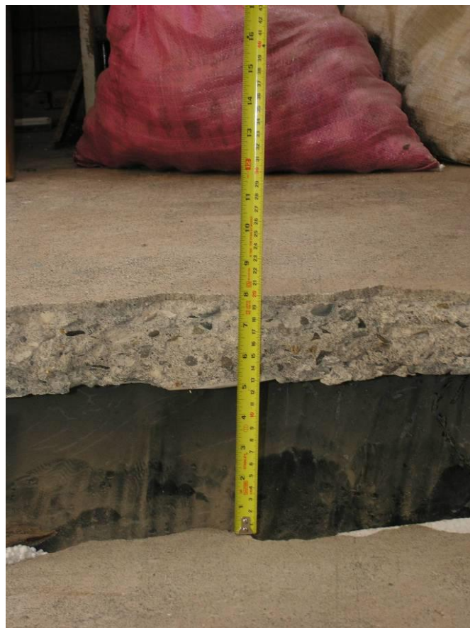
Figura H26. Condominio Andalién. Se observa grieta con desplazamiento vertical que provocó asentamiento en una vivienda.
