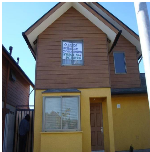
FiguraH20. Valle Noble. Vivienda con asentamiento, como lo indica el cartel. La vivienda se encontraba deshabitada.
