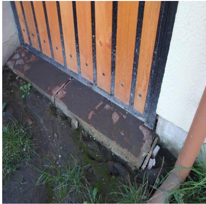
FiguraH19. Valle Noble. Se observan orificios por donde se produjeron “golpes de agua” en la vivienda. Nótese que la arena que cubre las gradas corresponde a las arenas arrastradas por la surgimiento de agua. Se observa, además, grietas en las gradas del patio.
