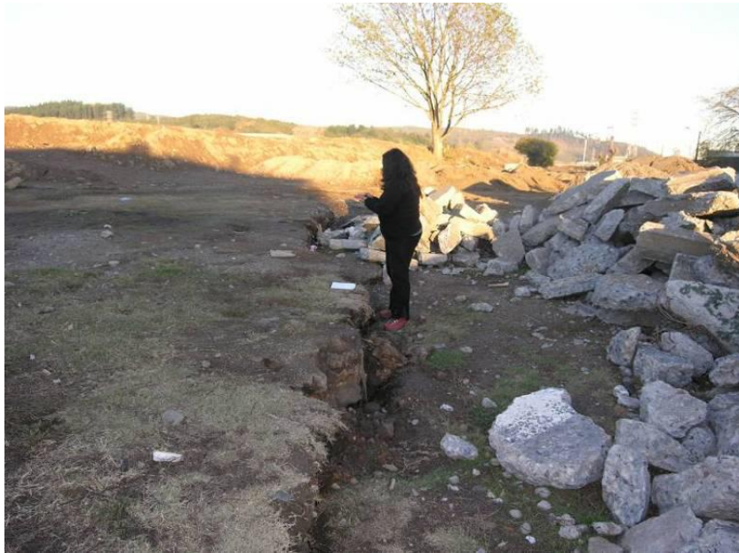
Figura H24. Condominio Andalién. Al sur del condominio hacia el puente ferroviario, se aprecian grietas en suelos arenosos, que corresponden a la llanura de inundación del río Andalién
