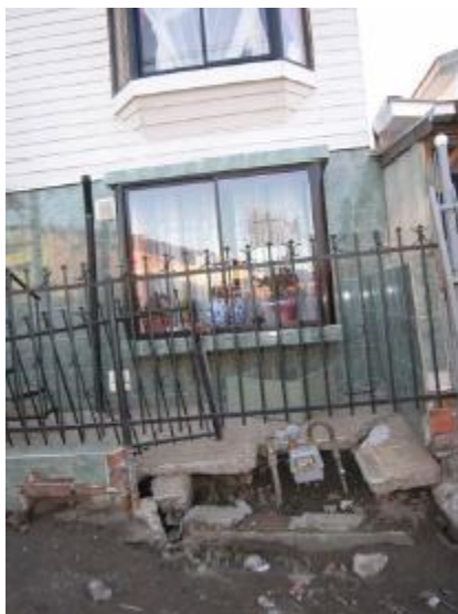
Figura H36. Población Buena Vista, Pasaje 4. Se observa daños en reja, terraza y cañerías de gas.
