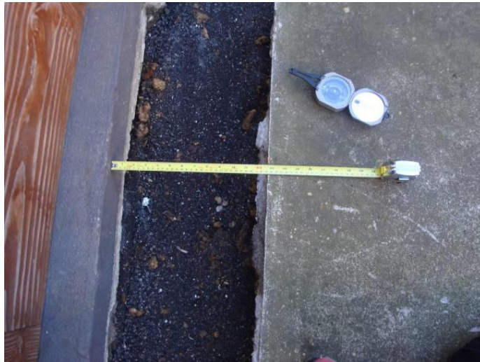
Figura H7. Barrio Lomas de San Andrés, Calle 8. Se observa desplazamiento horizontal de vivienda.
