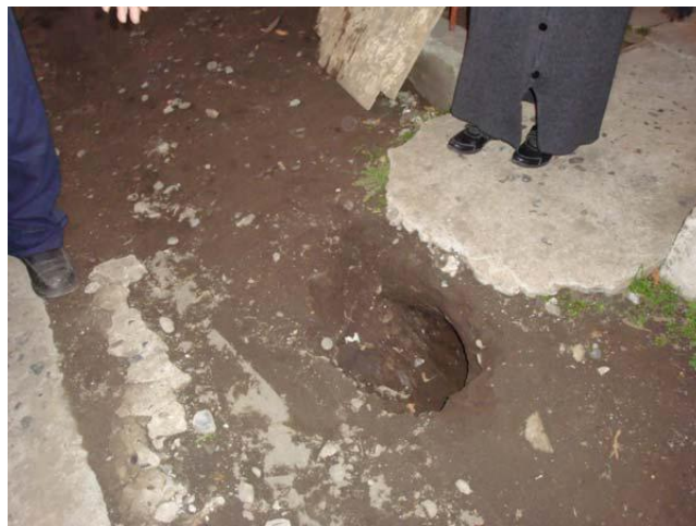
FiguraH32. Población Buena Vista, Pasaje 4. Se observa conducto circular de aproximadamente 40 cm por donde se observó, durante el sismo, “golpes de agua” y la formación de volcanes de arena, típicos de fenómenos de licuefacción de suelos arenosos saturados de agua.
