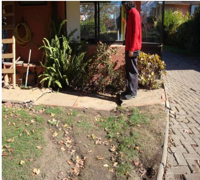
Figura H15. Barrio Lomas de San Andrés, Barrio Los Españoles, casa 6. Se observa hundimiento de vivienda y grietas de orientación N63E.
