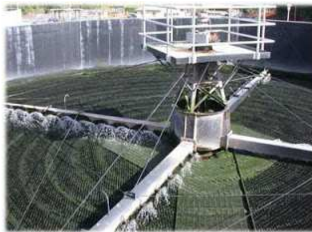
Figura 3.8.1, filtro de trampa, se distribuye lentamente el agua residual sobre el lecho de piedras. Las piedras tienen entre 6 y 9 centímetros de diámetro y el lecho es de 2 metros de profundidad.
