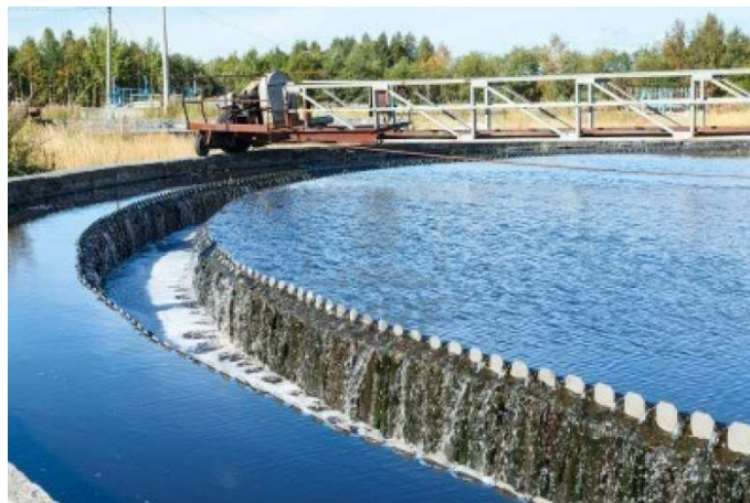
Figura 3.6.3- tratamiento inicial de las aguas residuales, el agua residual es bombeada a un reservorio donde se sedimentan los sólidos. De acuerdo a la subida del nivel del agua, este se derrama sobre cribas sucesivas de menor tamaño. El agua del nivel inferior, ahora libre de sólidos, entra en el canal de derramado y es bombeado a la instalación para el tratamiento secundario.
