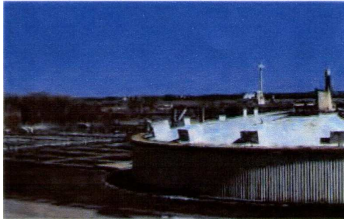
Figura 3.7.1- digester anóxico de fangos. Solo se muestra la parte superior del tanque; el resto está bajo tierra.
