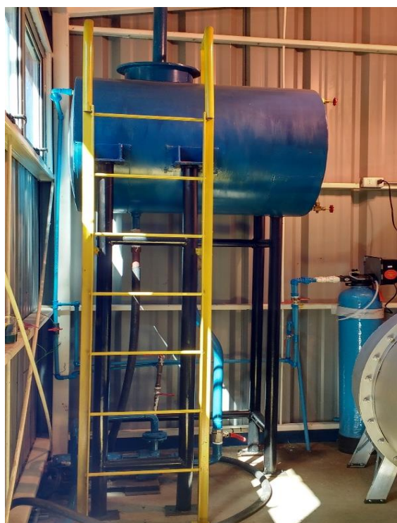
Figura 3.10 Estanque de alimentación de agua
