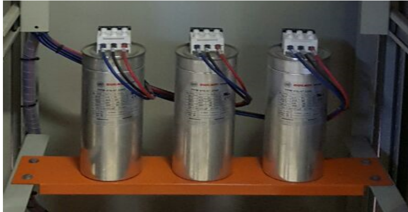
Figura 3.8: “Vista frontal de los condensadores”
