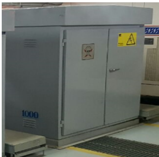
Figura 3.5: “ Vista lateral del transformador de distribución de 1000 kVA. ”
