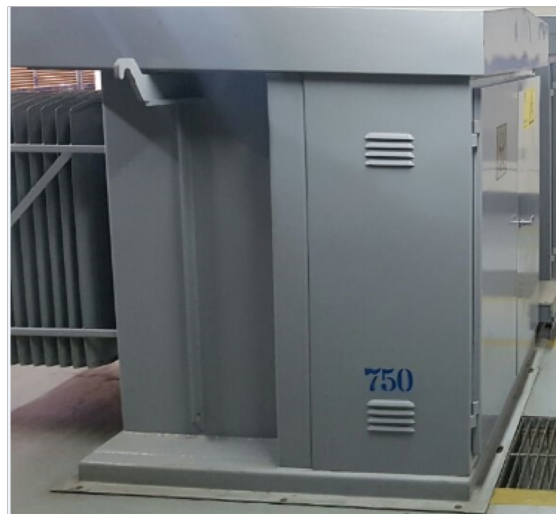
Figura 3.6: “ Vista lateral del transformador de distribución de 750 kVA. ”
