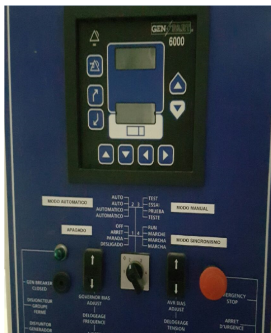
Figura 3.7 “Vista frontal de botonera del generador, se ve que está en la posición de MODO AUTOMÁTICO.”
